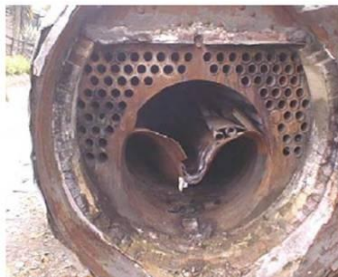
Figura 15. Efectos deformación hogar en una explosión de caldera de vapor
