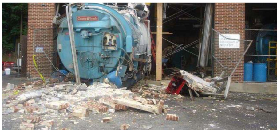
Figura 6: Explosión caldera de vapor en un hotel siglo XXI. Fuente: https://www.google.es/search?q=explosión+caldera+de+vapor
