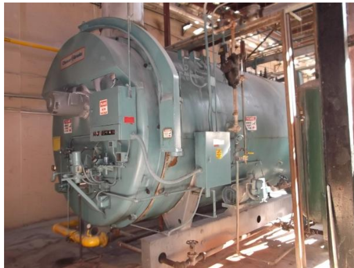
Figura 14: Sala con caldera de vapor
