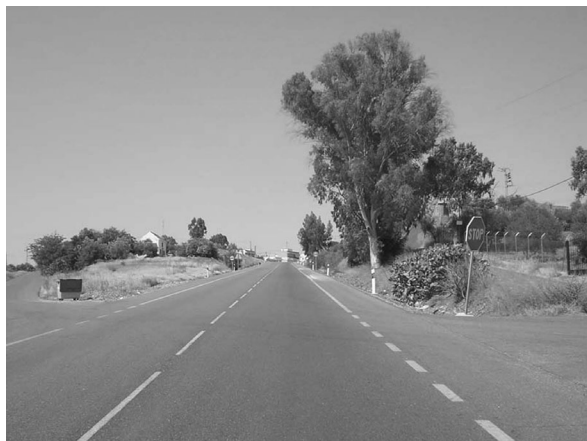
Lám. 9: La Cuesta de las Piedras, en El Arrecife. A la izquierda, casa de colono del siglo XVIII y rectificación primorriverista.
