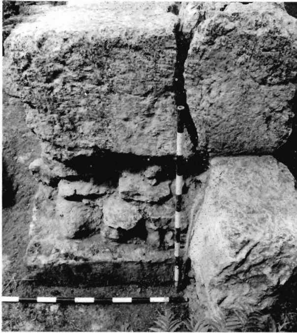
Lám. 7.- Detalle del relleno interno de la muralla romana y línea de fractura de los sillares del paramento Norte.
