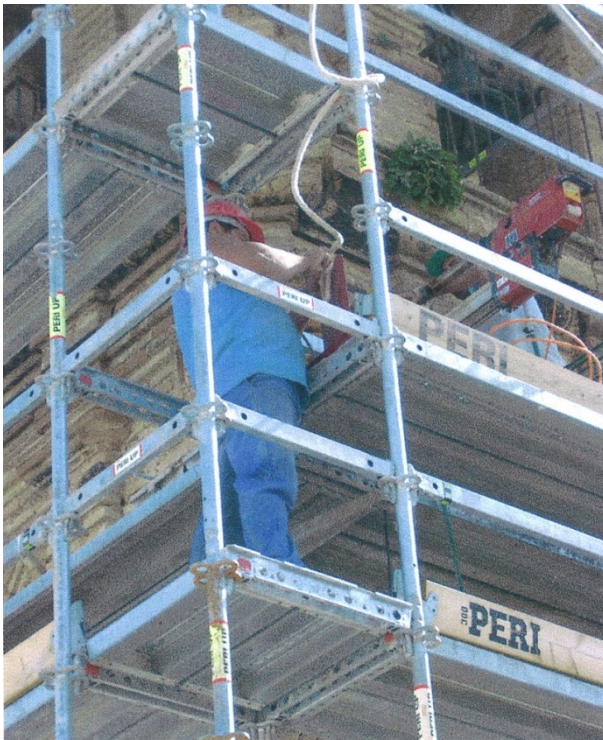
Figura 346 Consolidación de la Torre mediante el sistema de cosido estático. Foto del autor.
