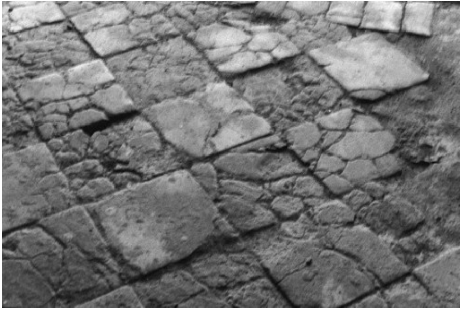
Figura 271 Estado del pavimento tras el derrumbe e incendio de las cubiertas. Foto del autor 1987
