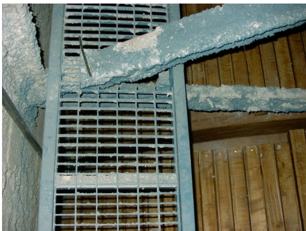
Figura 325 Materiales utilizados en SMLM rejilla electro-fundida en pasarela de mantenimiento. Foto del autor.
