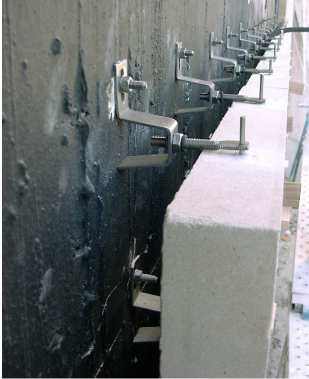
Figura 327 Materiales utilizados en SMLM cantería de arenisca fijada con elementos metálicos formando hoja ventilada. Foto del autor.
