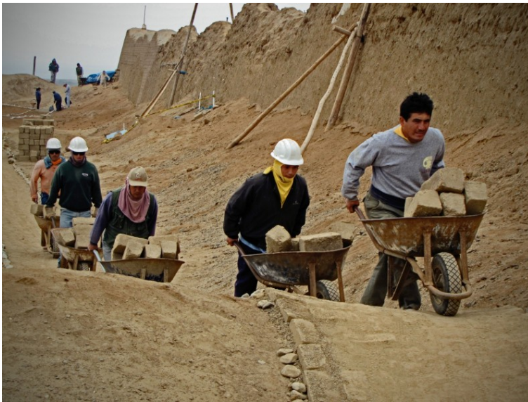
Figura 140 labores de conservación del palacio Rivero en Chan Chan, Trujillo Peru http://diariocorreo.pe/documents/10165/0/image_content_high_29149674_20120825145259.png
