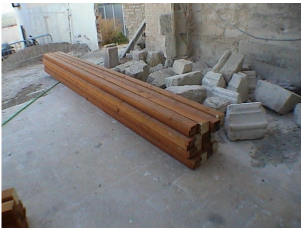
Figura 330 Materiales en SMLM sillares y restos de cantería procedentes de la destrucción de templo, reutilizados en la restauración. Foto del autor.
