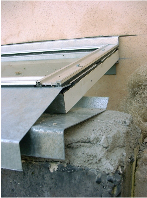
Figura 345 Detalle del sistema constructivo de los lucernarios. Diseño de los encuentros con muros antiguos y con los nuevos. Foto del autor.
