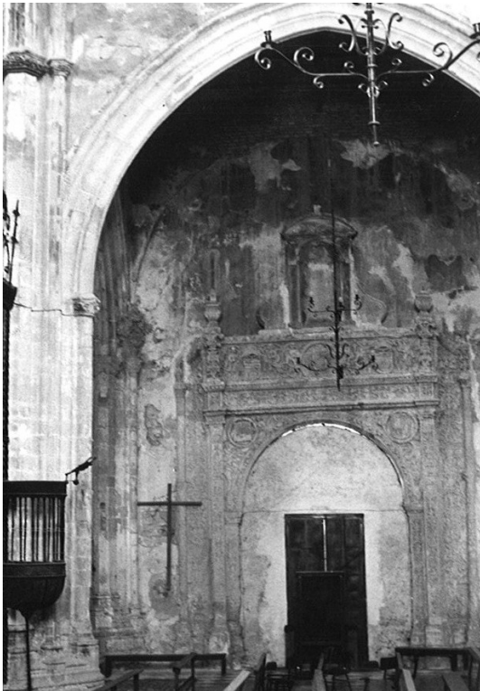
Figura 307 Capilla de Santa Ana antes de la restauración llevada a cabo por el autor. Foto del mismo
