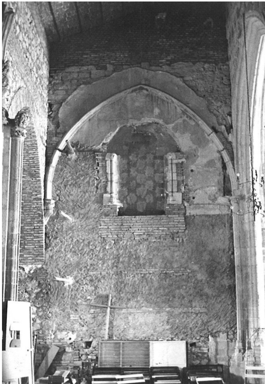
Figura 269 detalle de recrecidos murales y encuentros de cubierta. Foto del autor 1987
