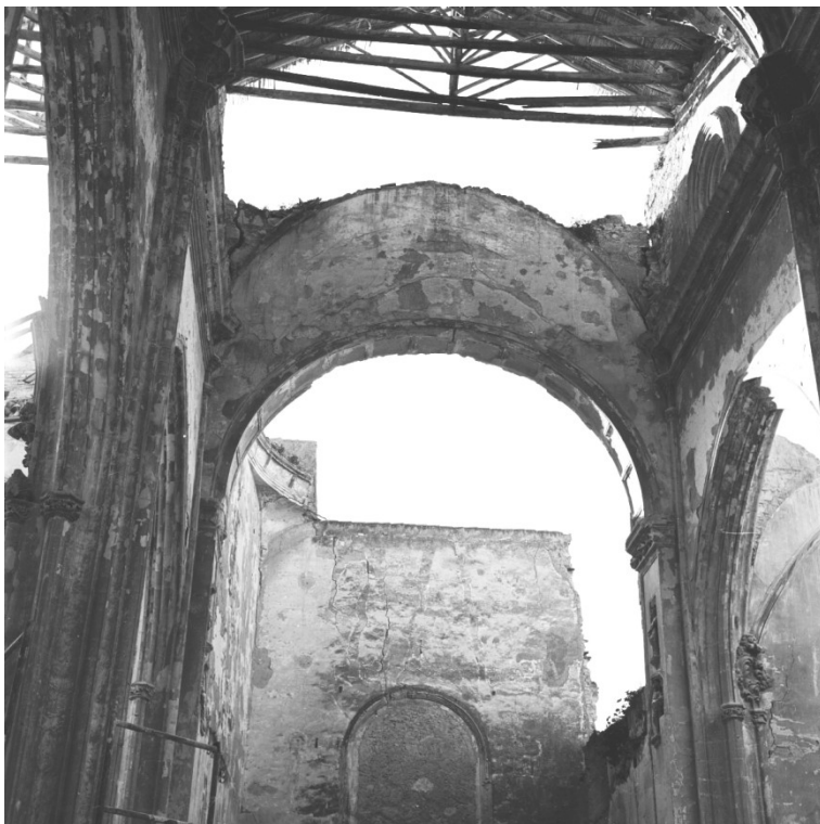
Figura 261 Coro en los pies de la nave central, volumen perdido en la actualidad. Foto del arquitecto J. Antonio Gómez Luengo 1972
