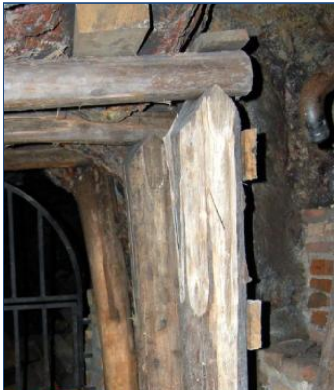
Figura 5. Ejemplo entibación con madera, en Minas de Almadén. Fuente: Parque Minero de Almadén.
