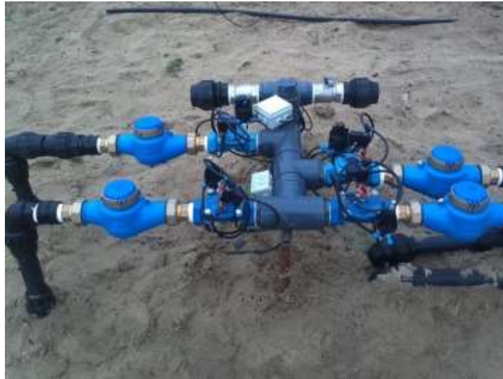
Figura 6. Contadores situados junto a las electroválvulas (uno por tratamiento)
