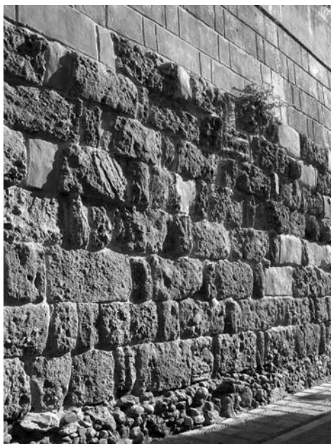
LÁMINA 4. Fábricas de sillería del lienzo sur del castillo o alcazaba de Marbella (Málaga).
