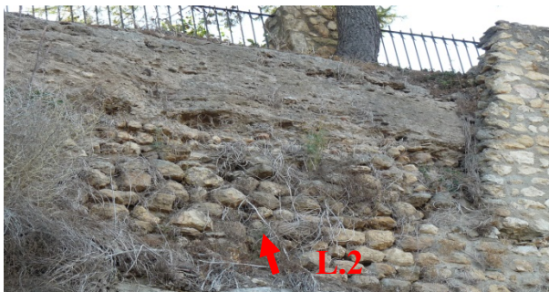
Fig.17 L.2: Tapia sobre zócalo de mampostería que asienta directamente sobre la roca.
