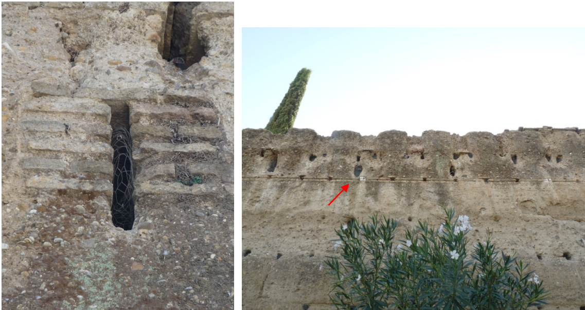
Fig.36 Izda.: Detalle Aspillera T.IV. Dcha.: Almenas cegadas y verdugada en L.5.
