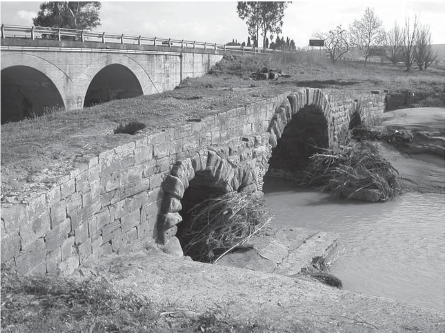
Puente Romano, después de las últimas inundaciones
