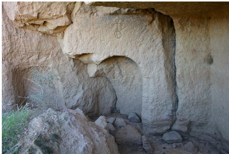
Imagen 2. Vista frontal de la Cueva 6 de La Sacristia. Retintamos el contorno de las cruces. Se puede observar cómo el nicho de la izquierda ha perdido el muro exterior. También se percibe la grieta por la que ha colapsado parte del techo, que pudo originar o acelerar la ruina y abandono de este cenobio
