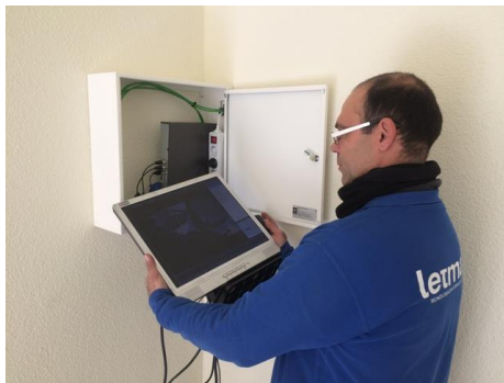
Fig. 12 Comprobación del sistema de vigilancia
