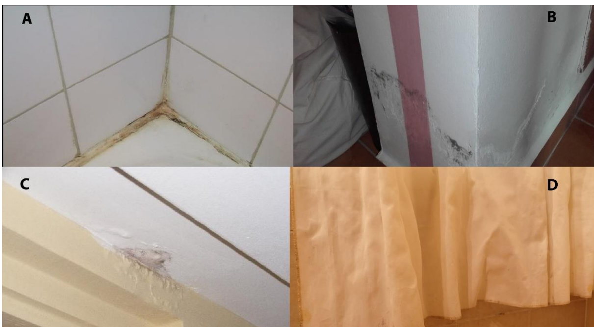
Figura 16. Los cuartos de baños son especialmente afectados por la humedad y a veces incluso el moho. Hotel Atlantic Palace (A), Hotel Palais des Roses (B), Odyssee Park Hotel (C-D) (fuente : https://www.tripadvisor.fr ).
