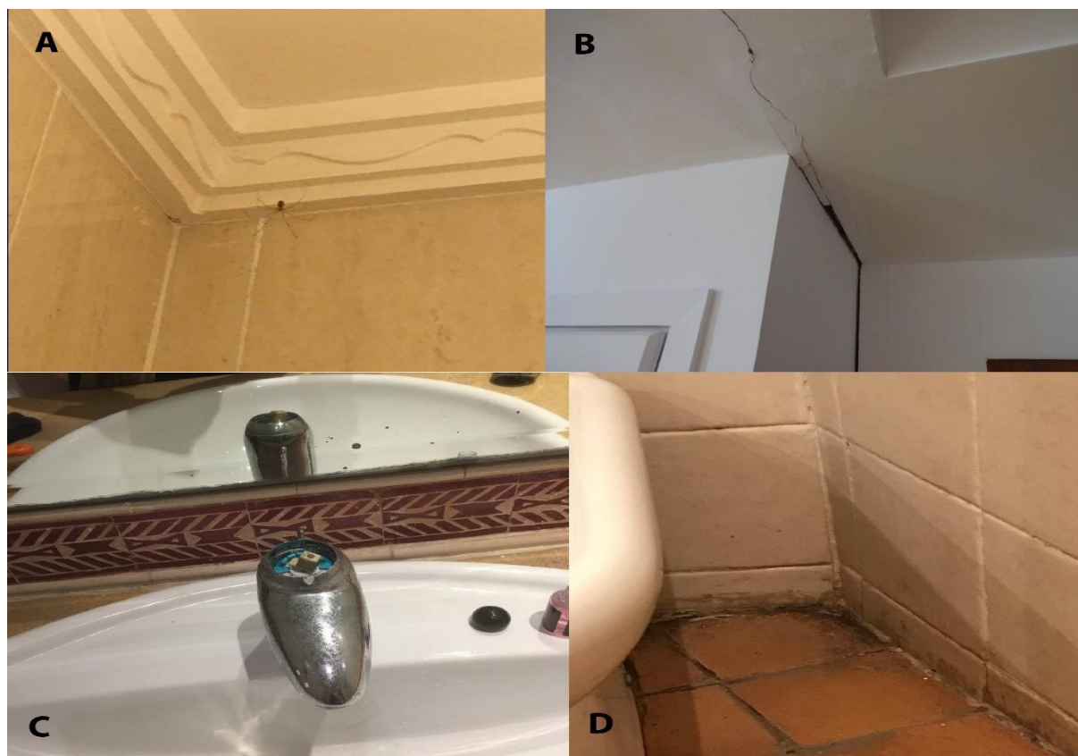
Figura 17. Telas de arañas por todos lados (Hotel Atlantic Palace) (A), las grietas en las paredes (Odyssee Park Hotel) (B), lavabo y sanitarios en estado avanzado de suciedad (Hotel Palais des Roses) (C-D) (fuente : https://www.tripadvisor.fr ).
