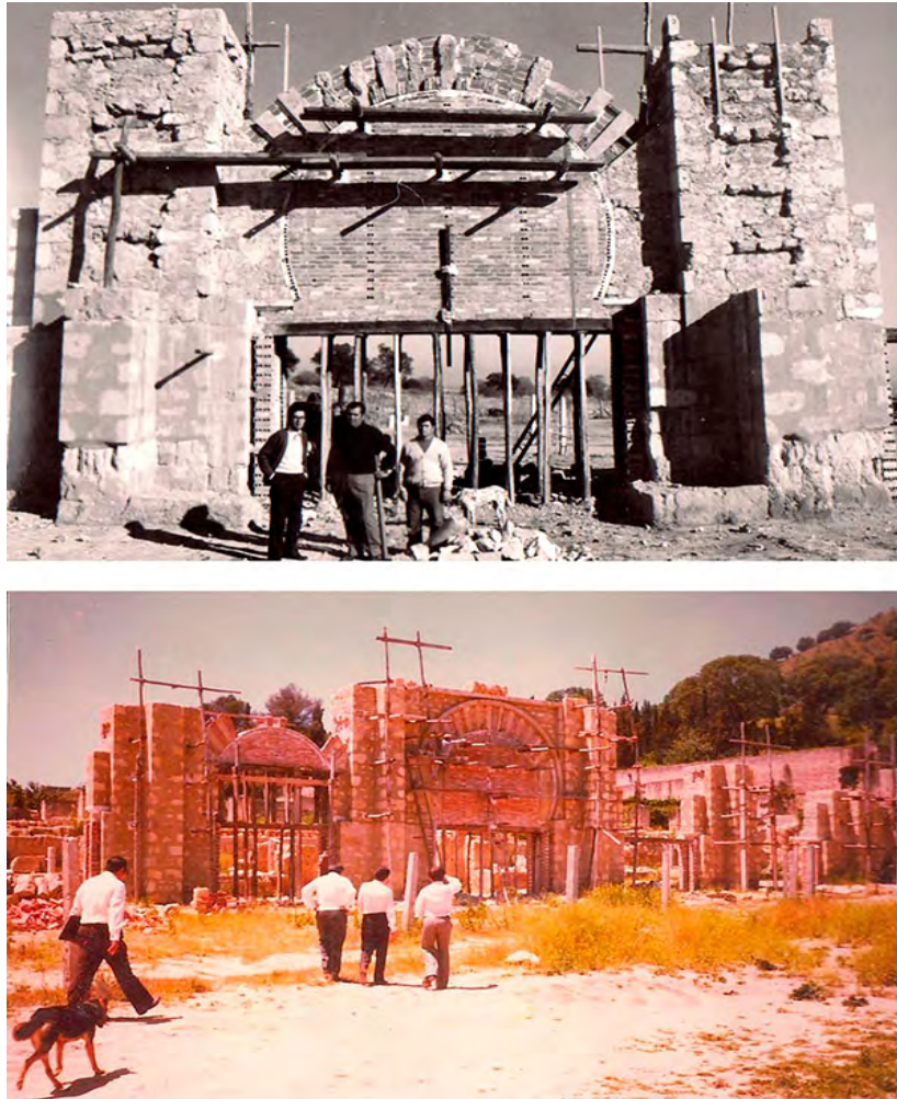
Figura 19. Córdoba. Medina Azahara. Proceso de restauración del pórtico oriental en tiempos de Rafael Manzano. Fuente: http://arqarqt.revistas.csic.es/index.php/arqarqt/article/view/218/342 .
