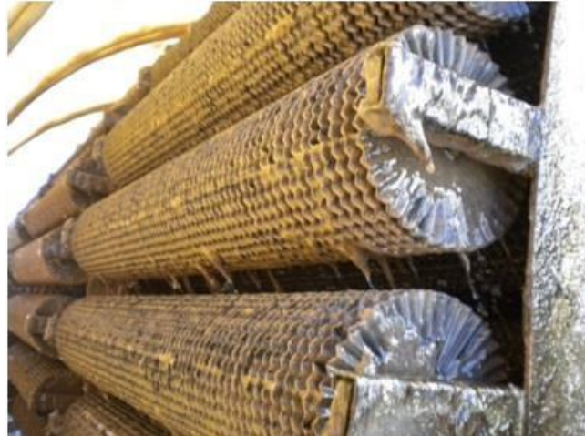
Figura 34. Detalle del sistema CBR de la EDAR de Nueva Carteya.
