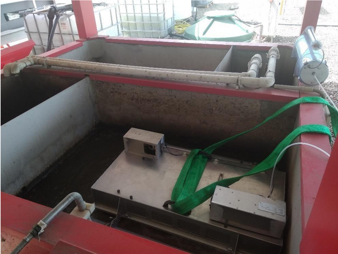
Figura 42. Fangos activos por aireación prolongada.
