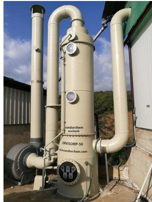
Figura 29. Lavador químico de gases (CondorchemEnviroSolutions, 2023).
