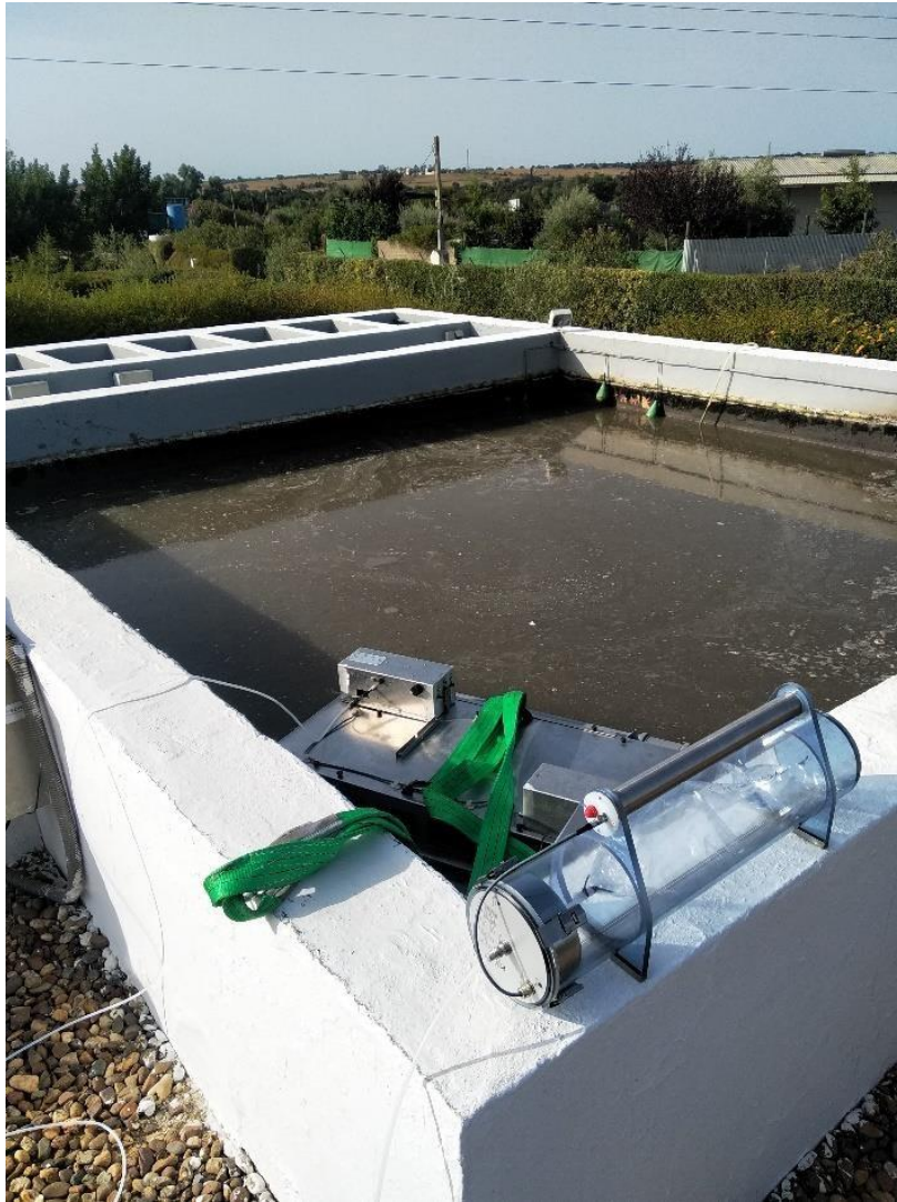
Figura 39. Tanque de homogenización.
