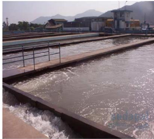
Figura 6. Foto del comportamiento superficial de un desarenador aireado (Leclerc et al., 2007).
