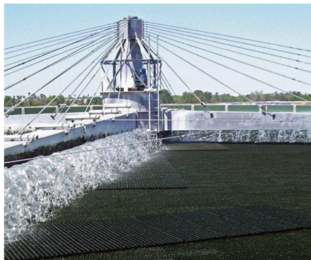
Figura 13. Filtro percolador (GEDAR, 2022).
