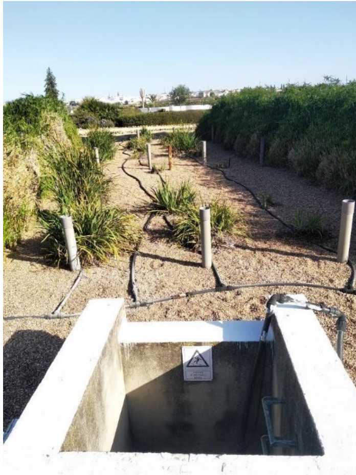
Figura 48. Humedal de grava plantado.
