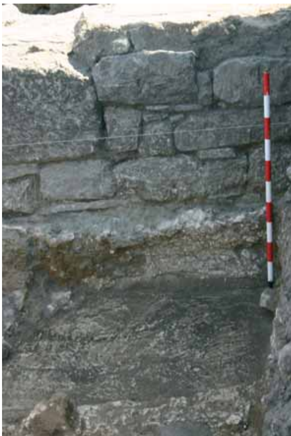
Figura 59. Detalle del adosamiento de la pared de estuco a la muralla (U.E. 706).
