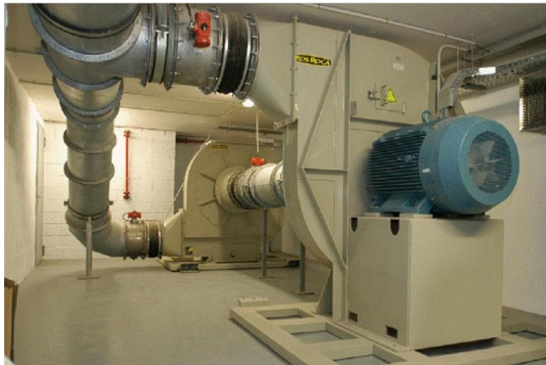
Figura 5.13: Sistema de aspiración en la central
