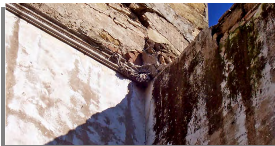
Figura 8.30-Restos in situ de la decoración de las pechinas que ornamentaban el Salón de Audiencias. (Fotografía: Rocío Velasco García).
