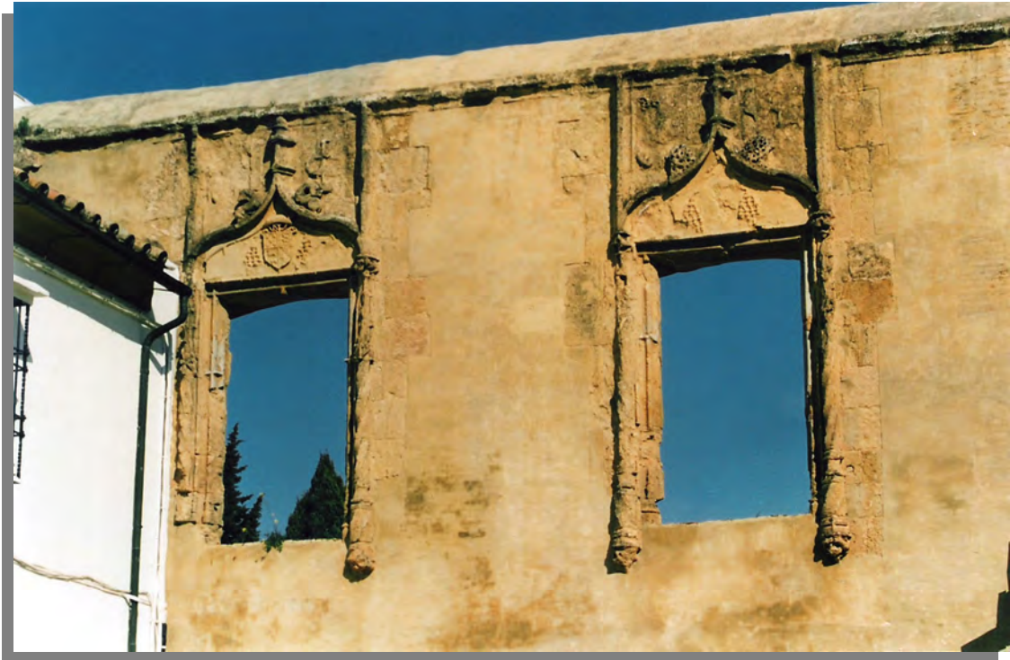
Figura 4.3.- Detalle de las ventanas que abren a Campo Santo de los Mártires. (Fotografía:Rocío Velasco García).
