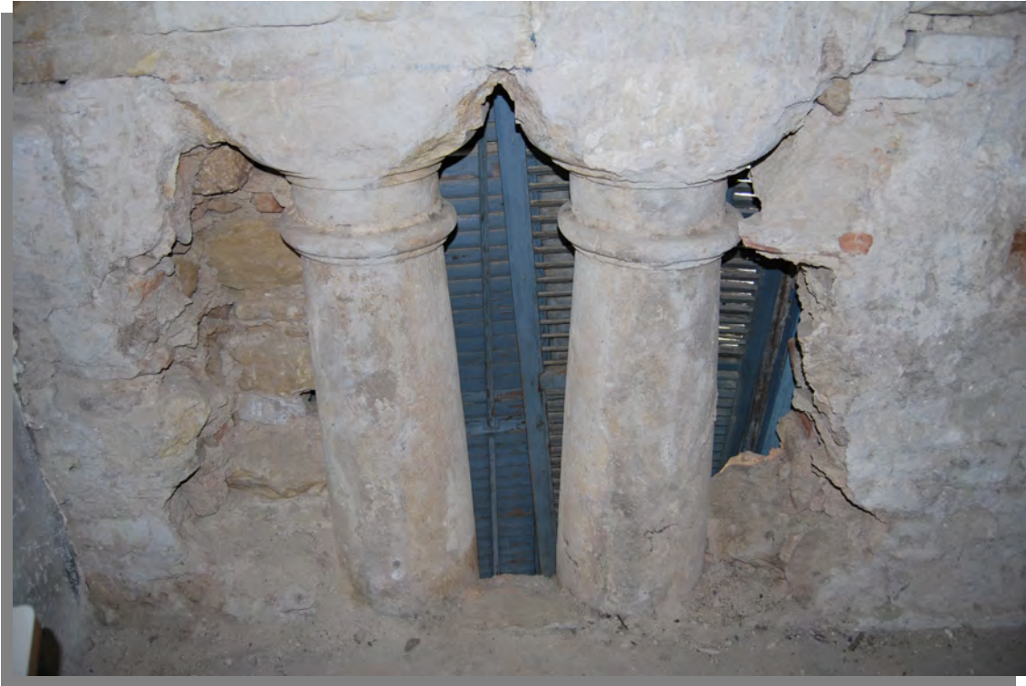
Figura 5.15-Columnas pareadas. Vista desde el interior de la galería. (Fotografía: Rocío Velasco García).
