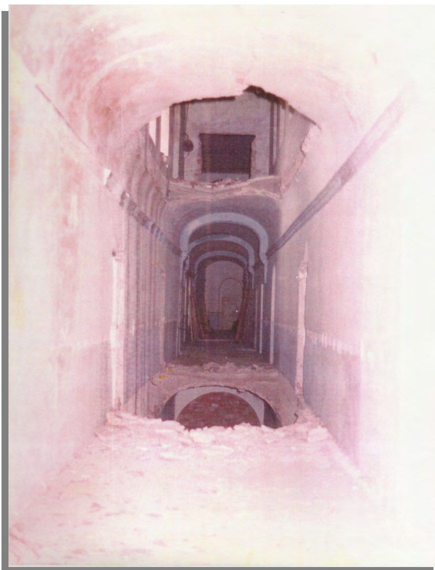
Figura 11.21-Estado de conservación de la crujía norte del edificio destinado a Biblioteca Pública Provincial. (Fotografía: Carlos Luca de Tena, APEALT).
