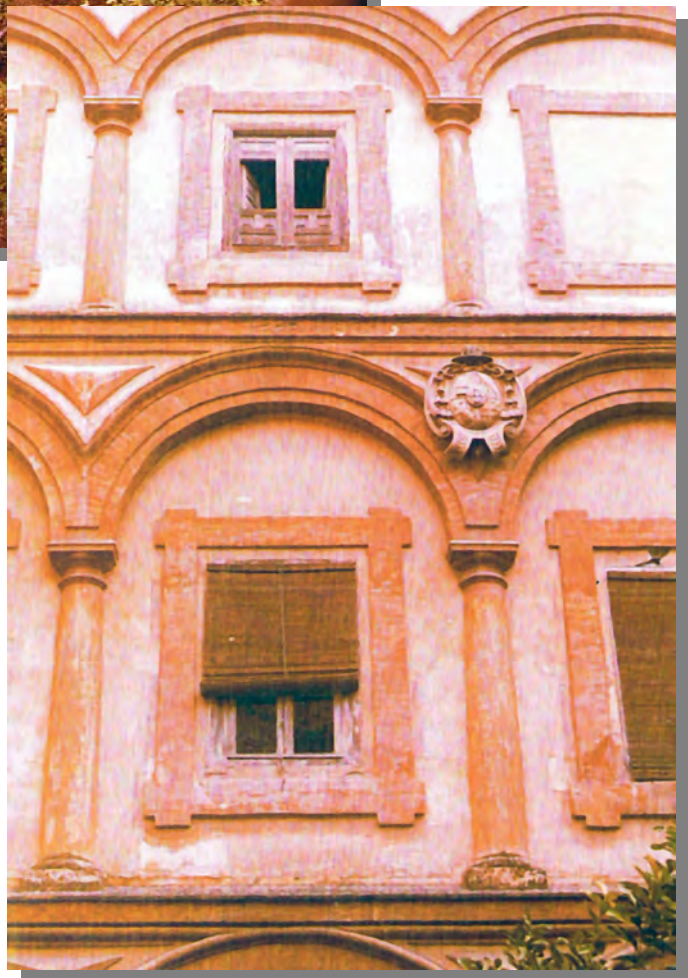
Figura 11.39-Detalle del estado de la fachada de las galerías altas en 1980. (Fotografía: Carlos Luca de Tena, APEALT).
