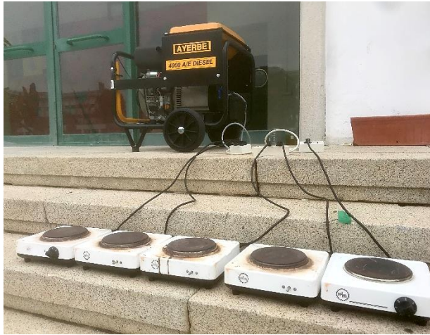
Figura A.12. Grupo electrógeno AYERBE 4000 Diésel conectado a placas eléctricas de 1000 W cada una.
