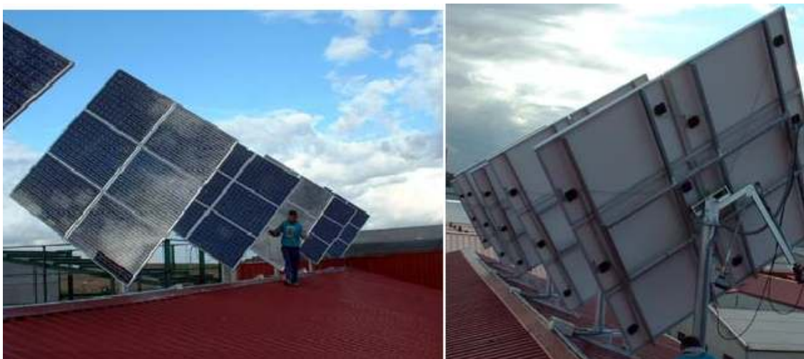
Figura 5. Seguidores a dos ejes de superficie instalados sobre cubiertas
