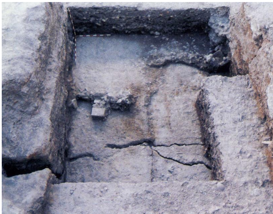
Fig. 119. Teatro: grietas en el pavimento y en la pared del vomitorio axial (MONTERROSO, 2002b, fig. 12).
