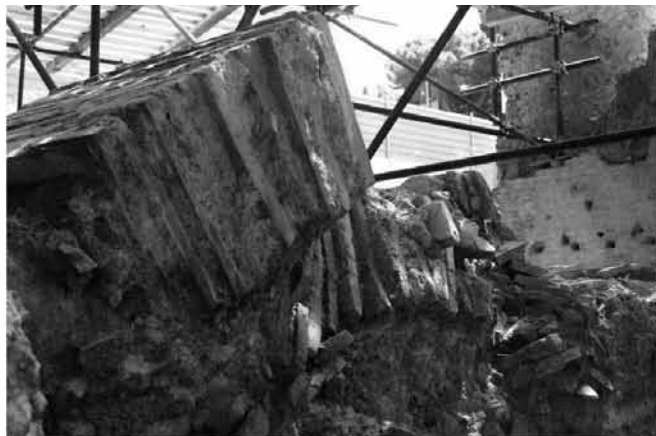
Derrumbe de la arcada provocado por el seismo del siglo IX
