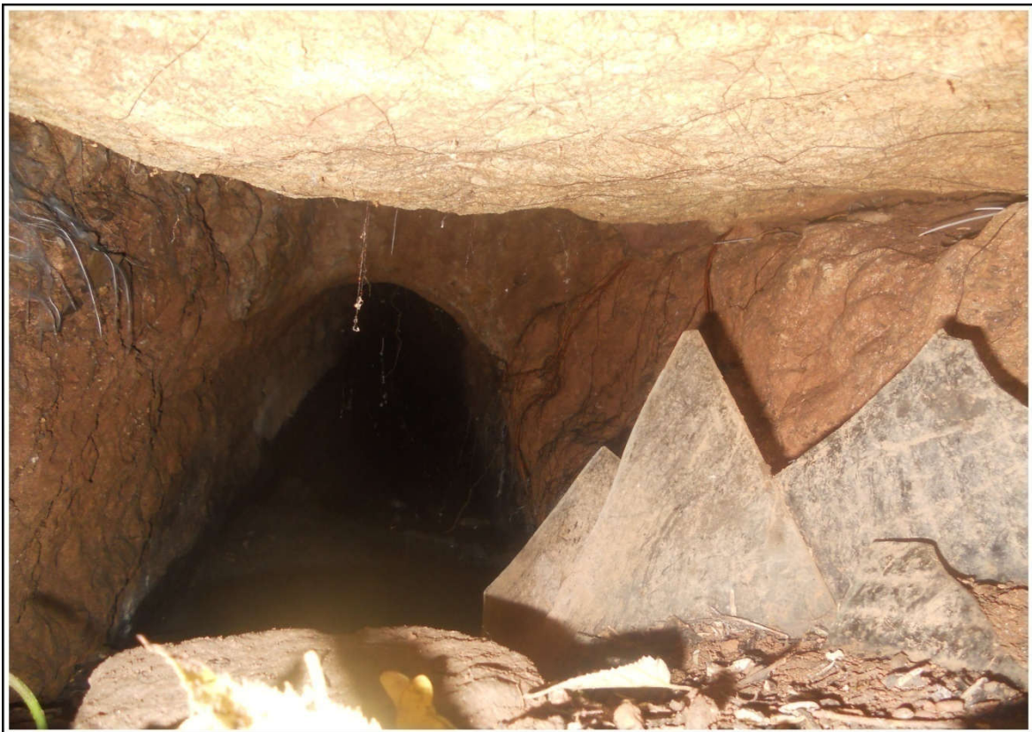
Foto (103). Círculación de agua en algunos tramos de esta conducción.
