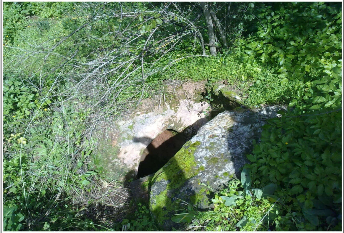
Foto (102). Pozo de resalto del acueducto. En su interior se aprecia cómo baja varios metros verticalmente la conducción.
