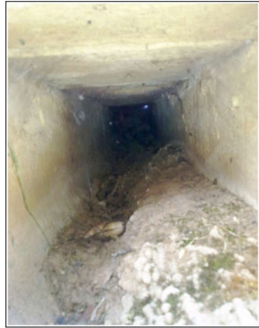
Foto (32). Toba depositada en el interior.
