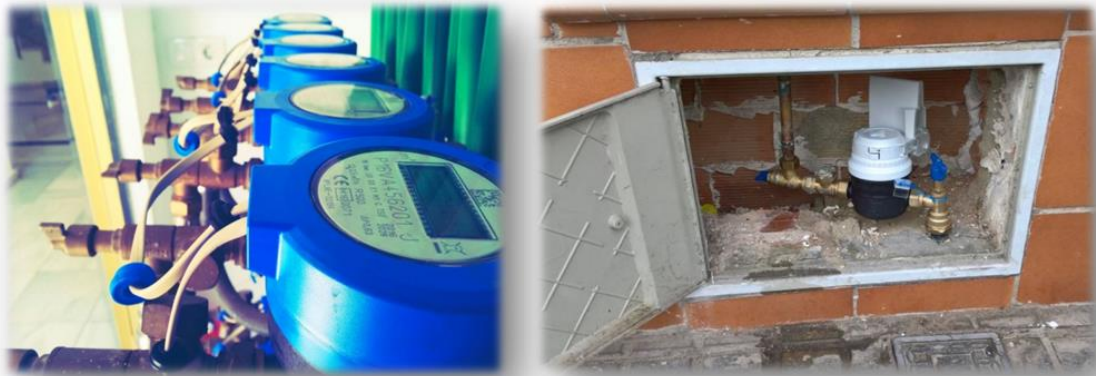
Figura 5.- Contadores en batería (Izq.) y contadores individuales (Dcha.). Fuente: Elaboración propia.
