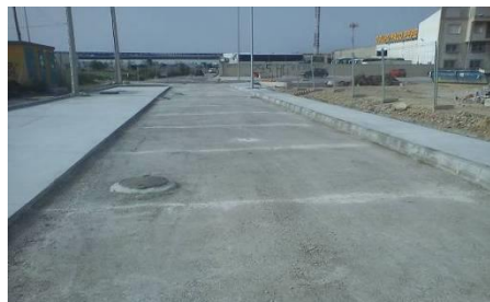
Figura 26. HSC-AR ya extendido con prefisuración.
