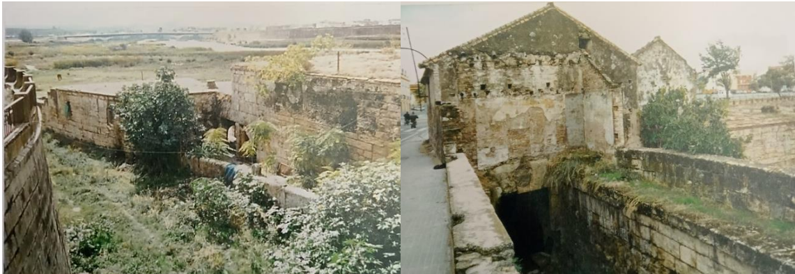
Ilustración 31 y 32. Fotografías tomadas en el 1998 de la fachada oriental del molino y de la entrada originaria al molino por el ala occidental. Se puede apreciar vegetación, ropa tendida, la propagación de líquenes en su fachada y un claro deterioro de la estructura. Recuperadas de Gerencia de Urbanismo: (Ref.: PG/UT).
