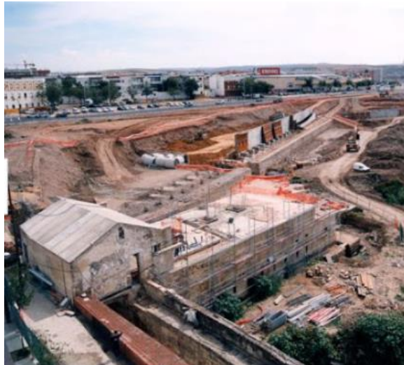
Ilustración 33. Proyecto de rehabilitación y restauración del molino y su entorno. Imagen recuperada de: Catálogo abierto de Arquitectura Contemporánea de Córdoba.
