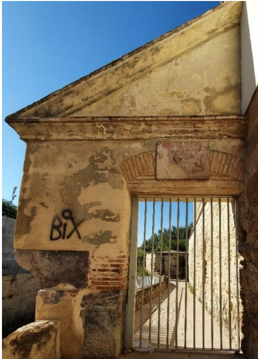
Ilustración 20. Pórtico de entrada a la rampa que da acceso a los batanes. Fotografía de autoría propia.
