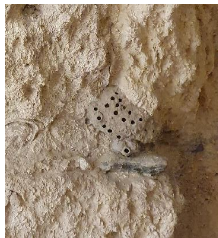
Ilustración 35. Avispero de tierra en una de las paredes del molino. Fotografía de autoría propia.
