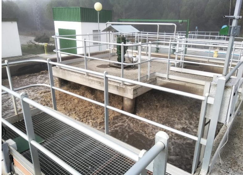
Figura 1.2.1.1. Reactor de aireación prolongada de la EDAR de Espiel (Córdoba).
