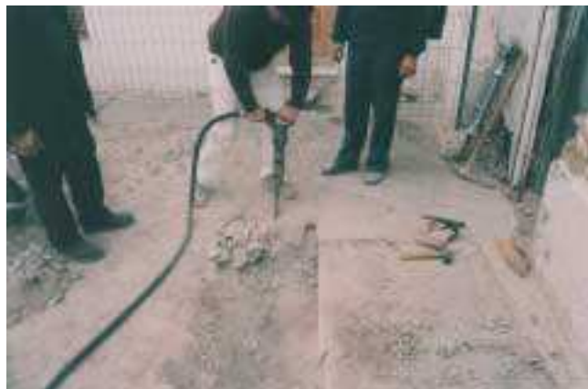
LÁM. II. Retirada del actual pavimento de la Plaza de la Alhóndiga con ayuda del martillo neumático.
