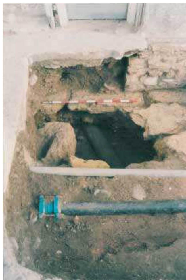
LÁM. V. Tubería contemporánea (U. E. 30) cuya instalación supuso la destrucción parcial del pavimento de época bajomedieval y/o moderna de la Plaza de la Alhóndiga.
