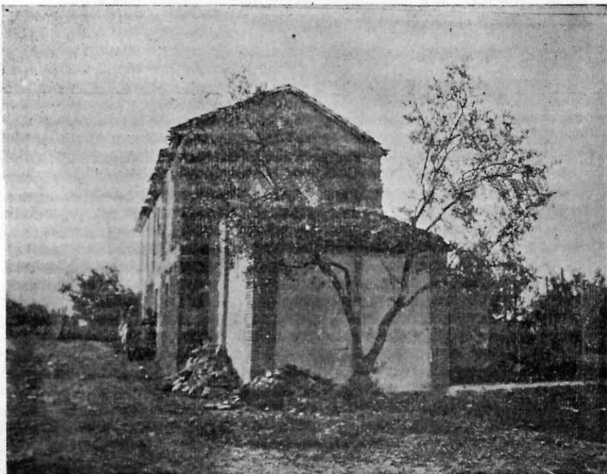
Esta casa sufrió grandes deterioros, habiendo destruido el granizo la techumbre.
