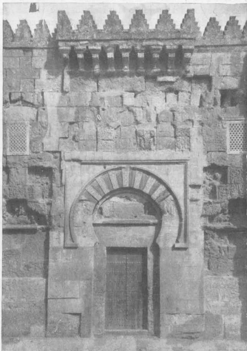
Estado actual de la portada de Mohamed I, después de quitadas las lonjas en 1928.
