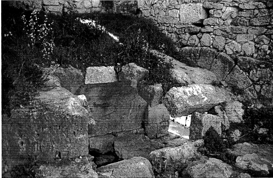
Fig. 3. Bóveda de medio cañón que separa la bóveda o entruescal de la sala de molienda. Aceñas de Tordesillas (Valladolid).
