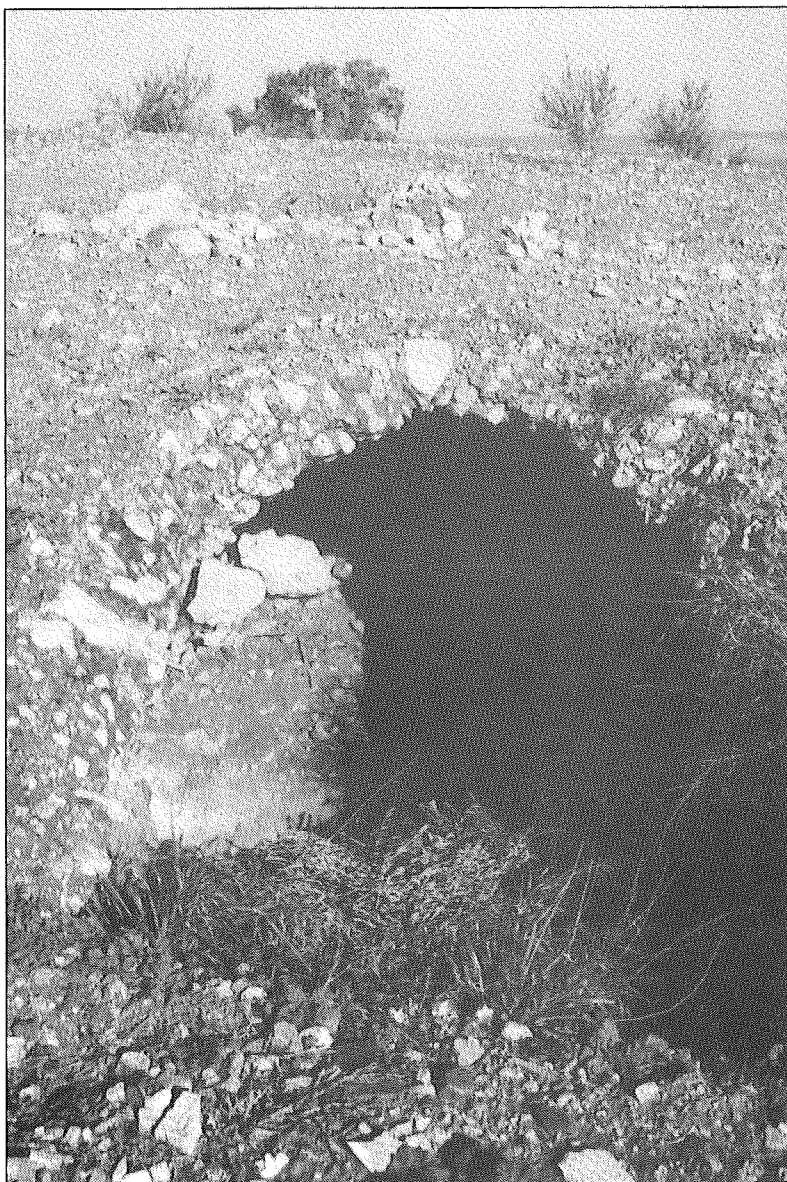
Lámina VII. Detalle de la construcción fabricada en opus caementicium , con cubierta abovedada, que se conserva en la cima del cerro.
