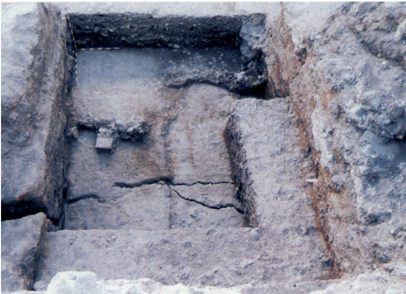
Figura 2. Grietas en el pavimento y en la pared del vomitorio axial del teatro (MORÍN et alii 2014)
